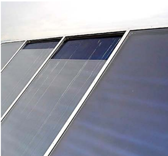
Beispiel: Gläser am Kollektor abgerutscht bzw. Glashalter defekt In Doren wurden bei den beiden Solaranlagen-Checks insgesamt 38 Anlagen überprüft.
